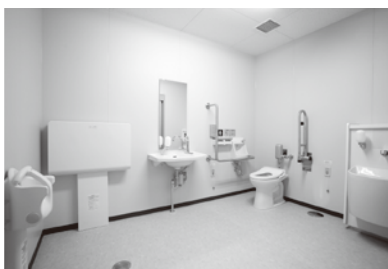
多目的トイレ
